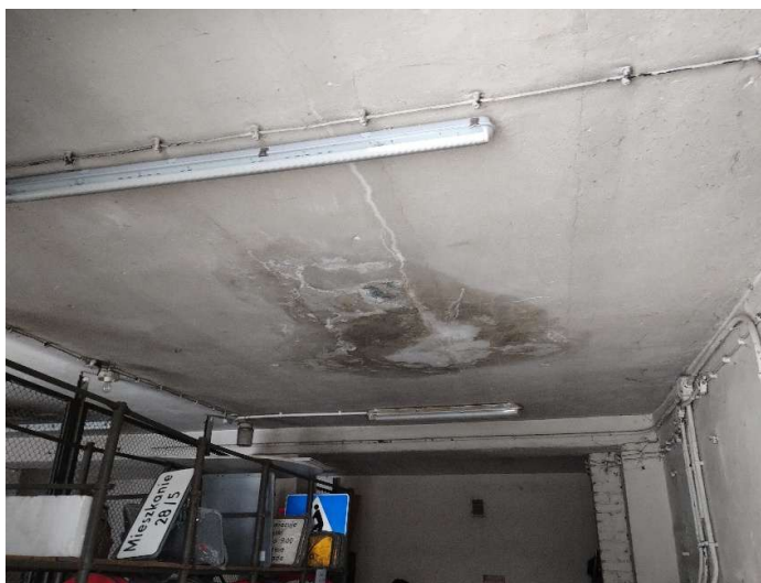
Fot.34 Pomieszczenia magazynowe. Widoczne ślady przecieków
