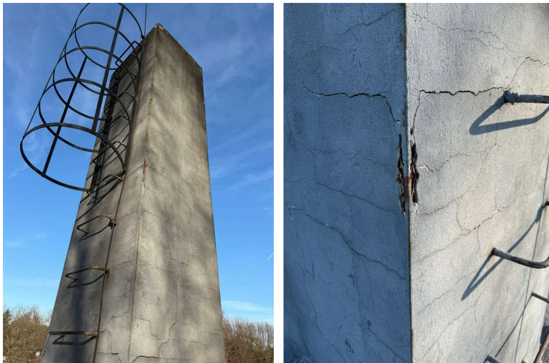
Fot. 22 i 23 Komin dymowy –widoczne spękania
