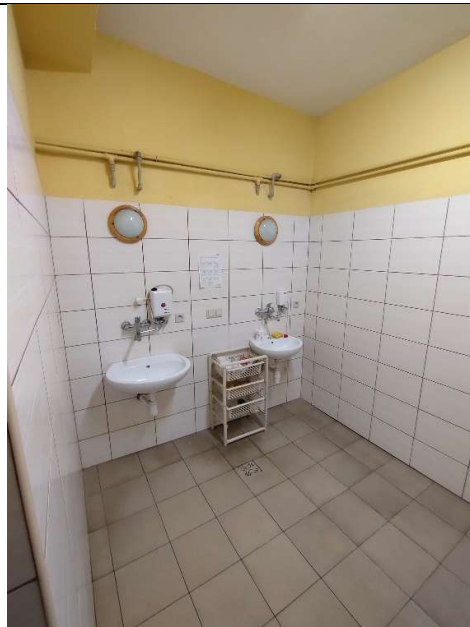
Fot. nr 4 – instalacja z rur stalowych połączoną z instalację z rur PP. Dwie baterie umywalkowe ze względu na przygotowanie CWU
