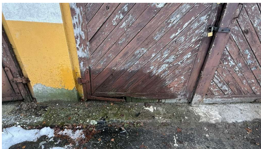
Fot.31 Bramy drewniane w bardzo złym stanie. Wygnite dolne ramiaki
