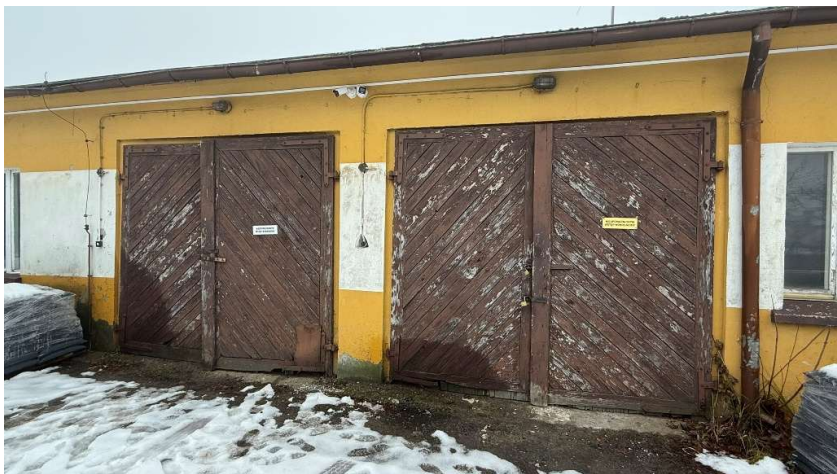
Fot.30 Bramy drewniane w bardzo złym stanie
