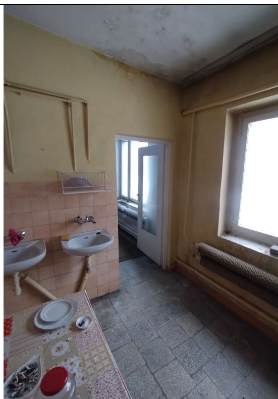
Fot nr 2 – przybory sanitarne wraz z podejściami odpływowymi PVC
