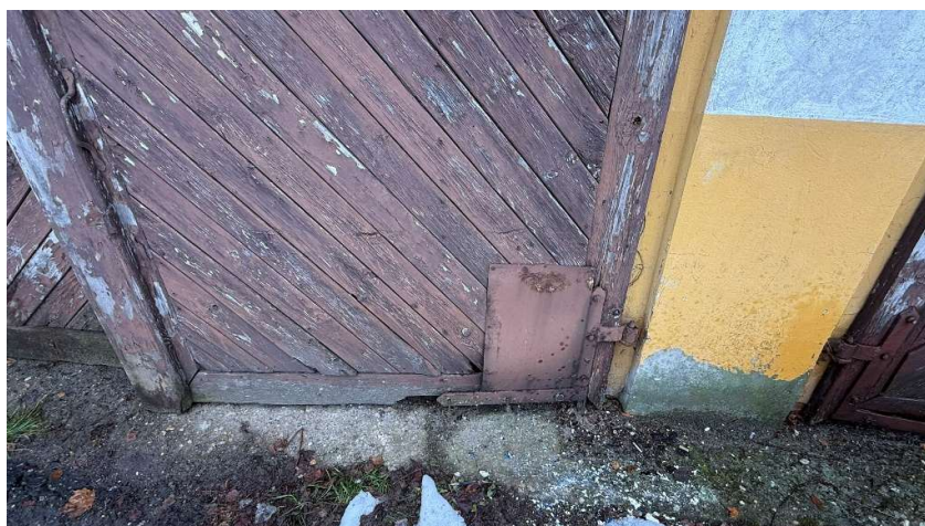
Fot.32 Bramy drewniane w bardzo złym stanie. Wygnite dolne ramiaki
