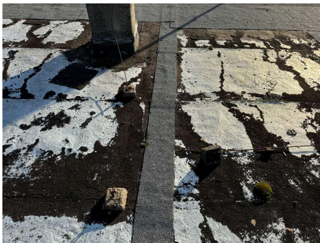
Fot. 17 Pokrycie dachu – widoczne ślady doraźnych napraw wykonywanych w różnych okresach przy użyciu różnych materiałów
