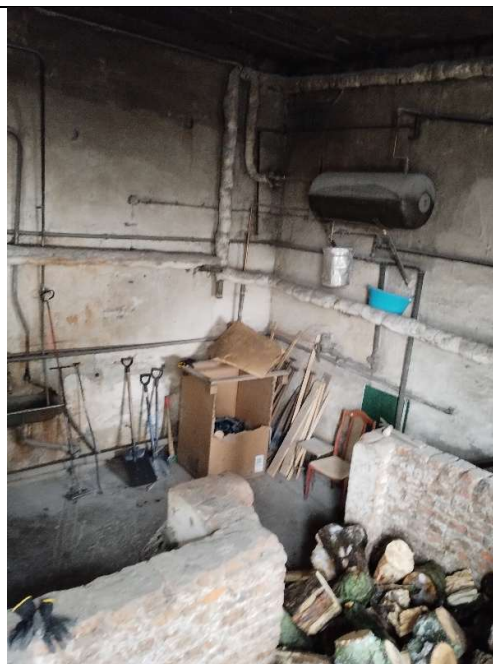
Fot. nr 8 – zasobniku CWU zasilany z instalacji ogrzewania – wyłączony z eksploatacji. Instalacja ogrzewania z izolacją nie spełniającą aktualnych wymagań WT
