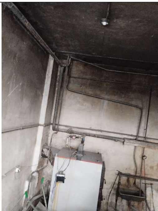
Fot. nr 7 – Kocioł na paliwo stałe – kocioł pozaklasowy. Instalacja ogrzewania nie wyposażona w izolację termiczną
