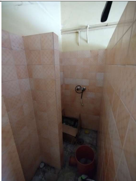
Fot. nr 3 – instalacji z rur stalowych. Podejście instalacji dla baterii w ścianie
