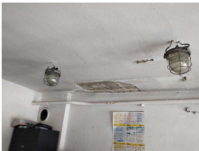
Fot.35 Pomieszczenia magazynowe. Odpadający tynk
