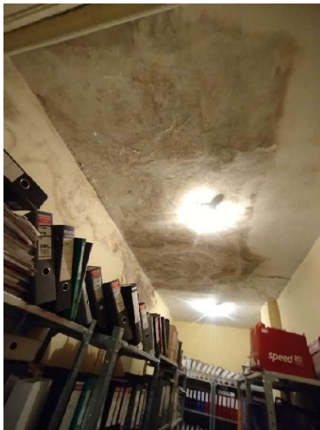
Fot.40 Pomieszczenia archiwum. Silne zawilgocenie sufitu
