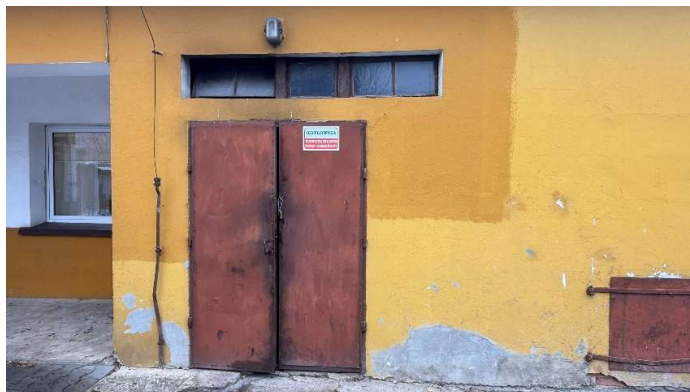
Fot.33 Brama kotłowni w złym stanie.
