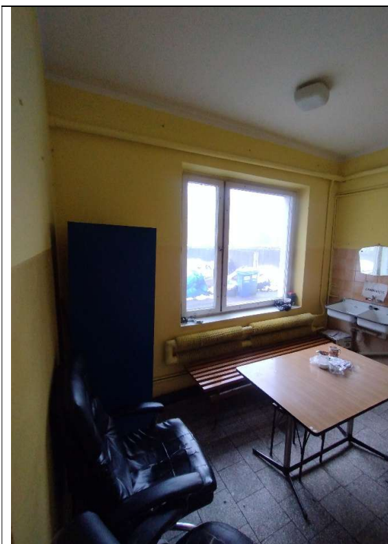
Fot. nr 1 – zlew żeliwny (wyłączony z eksploatacji)
