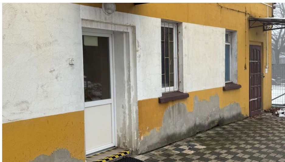
Fot.15 Elewacja północna – ślady doraźnych napraw tynku
