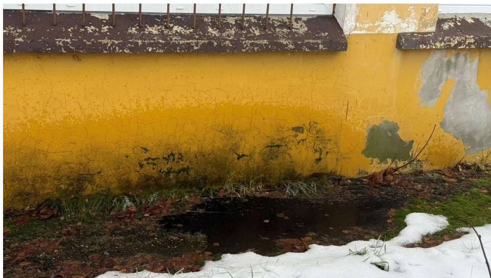
Fot.14 Elewacja zachodnia – nieprawidłowo ukształtowana opaska betonowa, zlegająca woda powodująca zawilgocenie ściany
